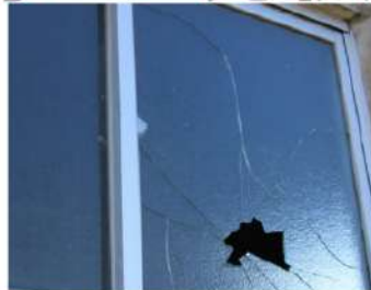
建物の破損 不法投棄の確認
