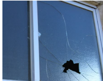
建物の破損 不法投棄の確認
